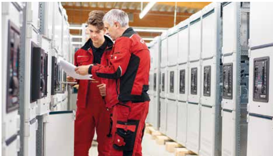
Die eigene, moderne Fertigungsstätte am Unternehmensstandort Borna (Eula) ermöglicht eine individuelle, flexible Herstellung von Schaltanlagen.
